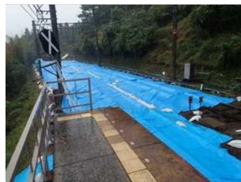
上古沢駅線路土砂流出
