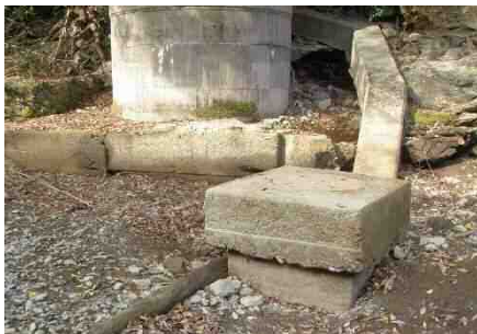
＜基礎が露出した九度山水源＞
