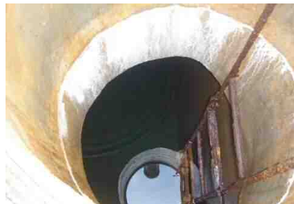
＜配水池内の腐食した内部梯子＞
