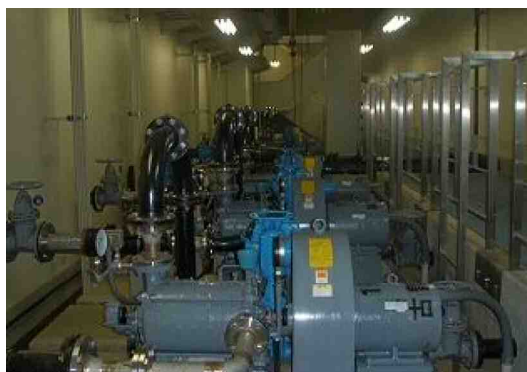
＜九度山浄水場の送水ポンプ設備＞
