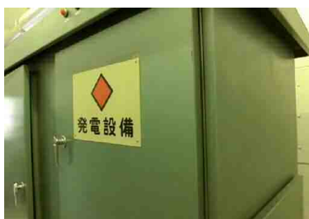
＜九度山浄水場の自家発電設備＞
