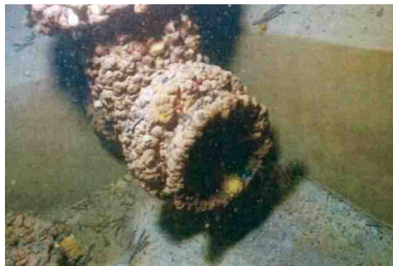
＜腐食が激しい九度山配水池内配管＞
