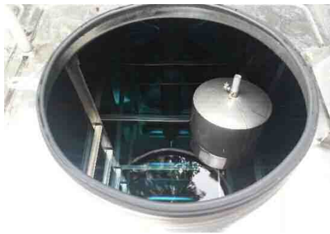
＜SUS製配水池の内部＞
