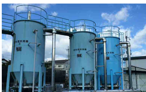
＜九度山浄水場の前処理ろ過設備＞
