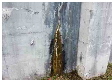
＜壁から漏水する古沢配水池＞
