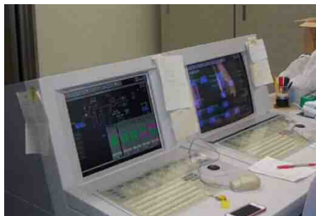
＜水道施設監視設備＞
