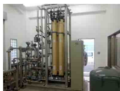
＜河根浄水場の膜ろ過施設＞
